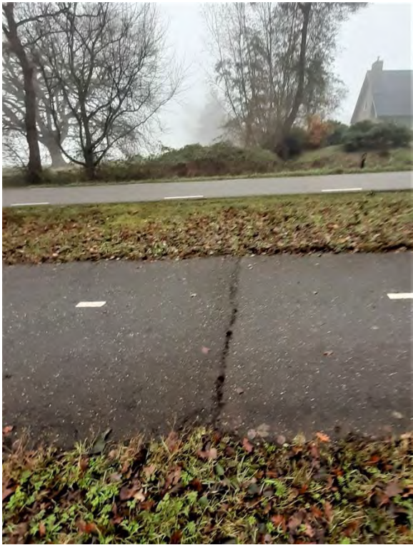
Peelrandbreuk zichtbaar in het asfalt
